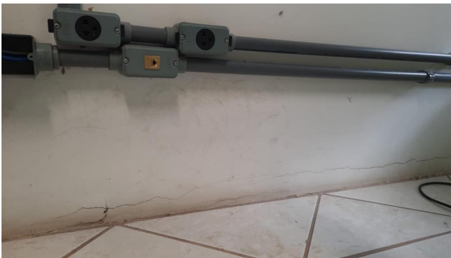
Figura 57 – rachadura na parede
