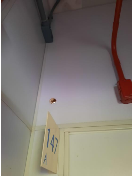
Figura 65 - há um buraco em cima da porta na divisória
