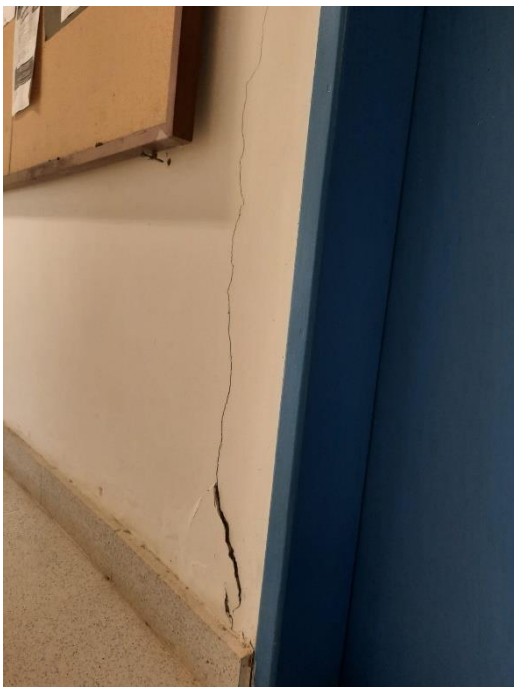
Figura 4 - rachadura na parede da sala 22
