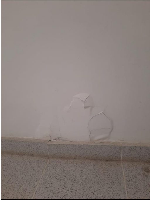
Figura 5 – infiltração na parede entre os banheiros dos servidores
