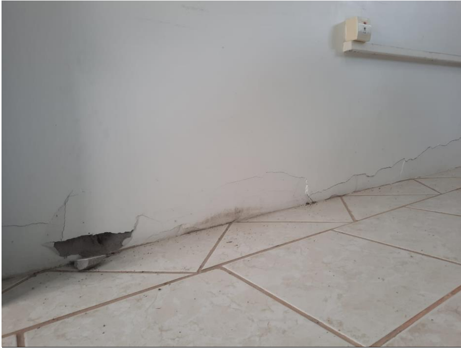
Figura 41 – parte do reboco soltando
