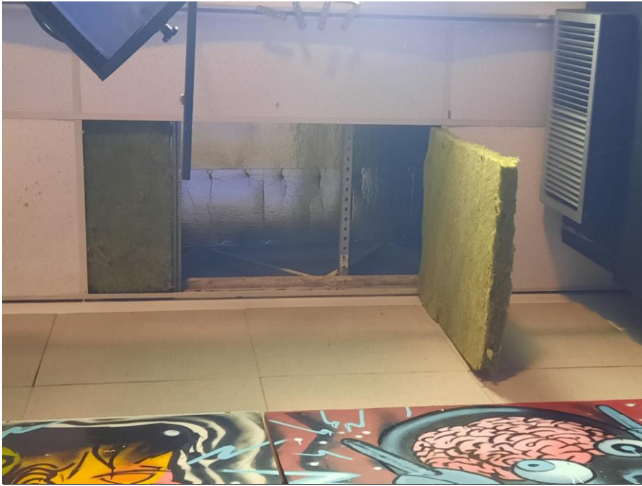
Figura 15 – parte do isolamento do teto do estúdio está soltando
