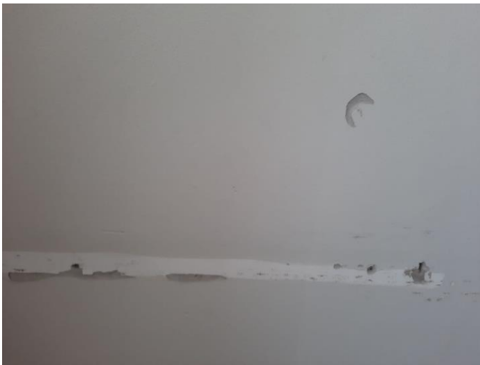
Figura 64 - há necessidade de pintura
