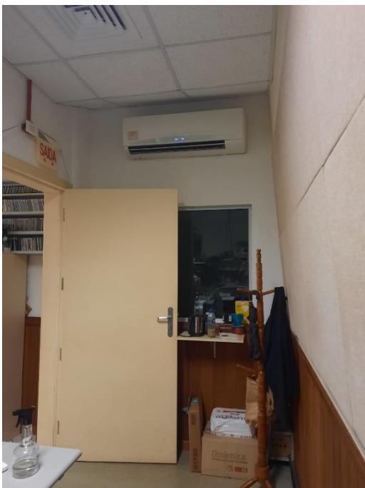
Figura 28 – ar-condicionado da sala de controle que não está gelando
