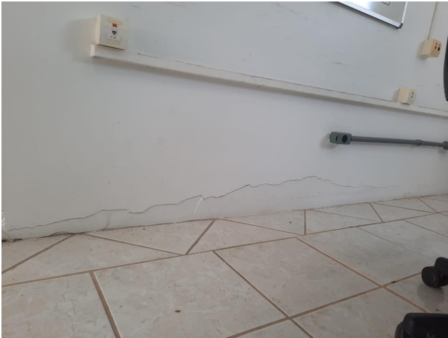
Figura 42 – rachadura em uma das paredes
