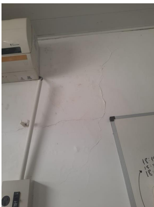
Figura 21 – infiltração na sala 31
