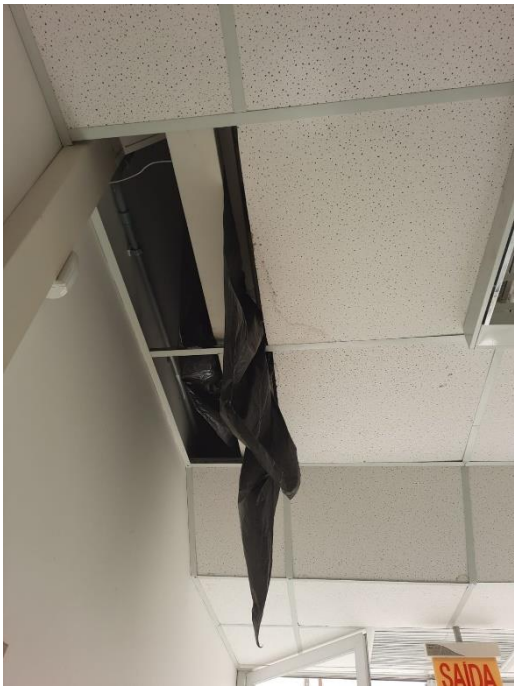
Figura 30 – parte do forro soltou por conta de infiltração
