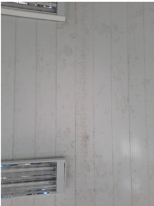
Figura 47 – parte do forro com mofo
