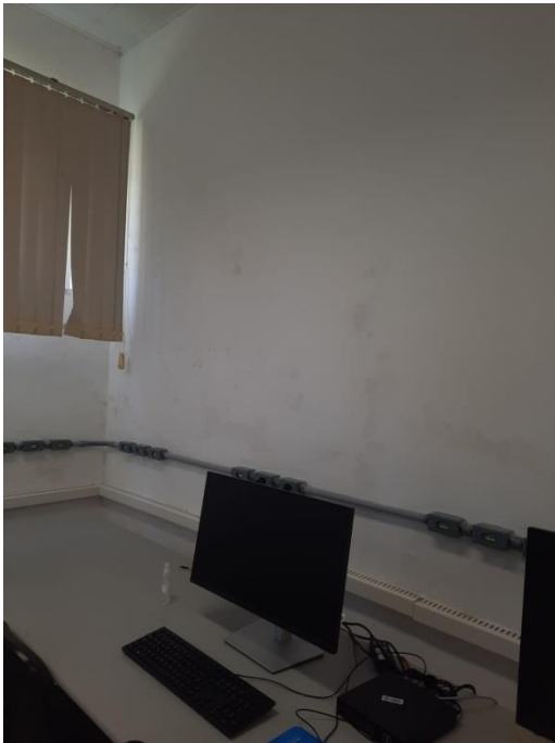
Figura 38 – Parede com mofo
