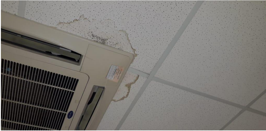
Figura 31 – infiltração no Labrádio
