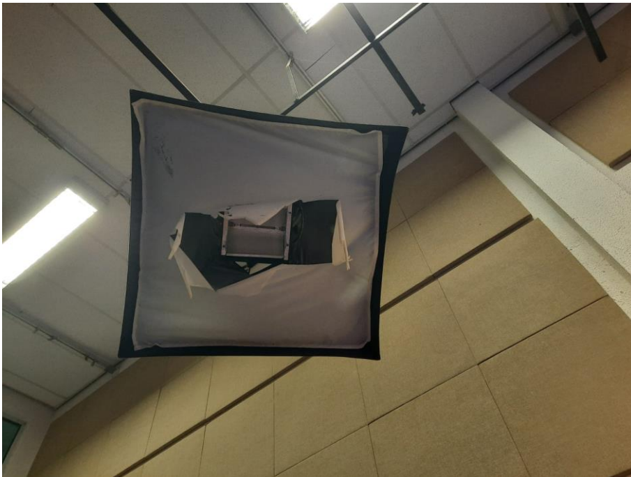
Figura 16 – refletor está com proteção rasgada
