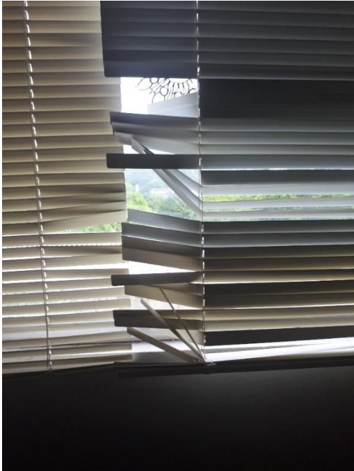
Figura 60 – parte das persianas da sala 144 estão quebradas
