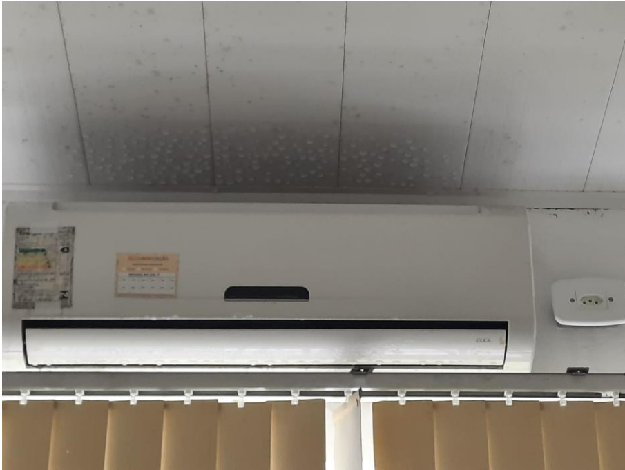
Figura 48 - infiltração na sala vinda pelo ar-condicionado
