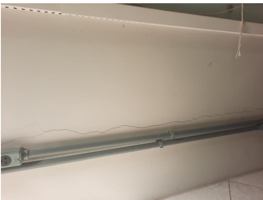
Figura 23 – rachadura na parede da sala 32
