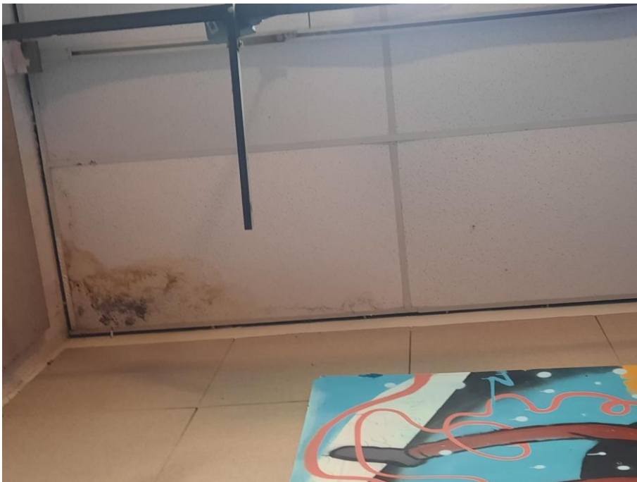
Figura 14 – infiltração no teto do estúdio de TV
