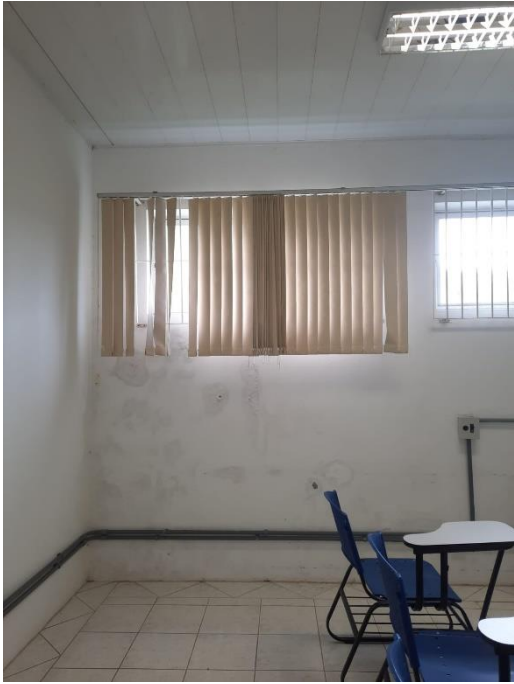
Figura 46 – Parede com mofo e infiltração
