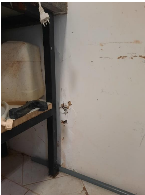
Figura 37 – infiltração na parede
