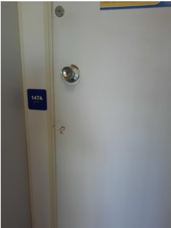
Figura 62 - a maçaneta da sala não traz segurança
