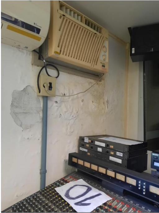
Figura 17 – infiltração na parede do LabTele
